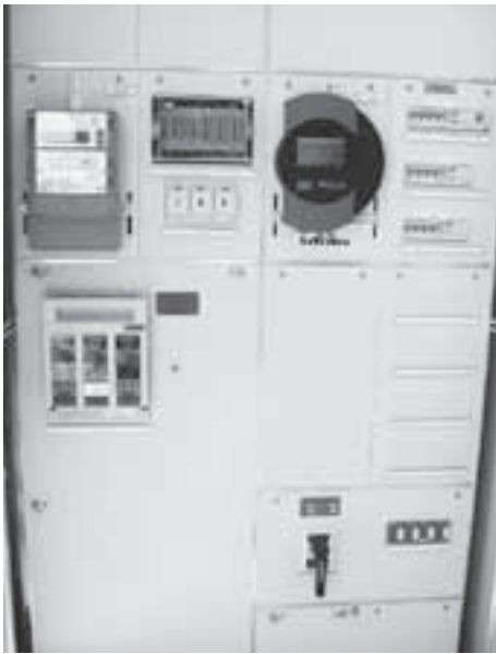
Gehirn der Anlage
