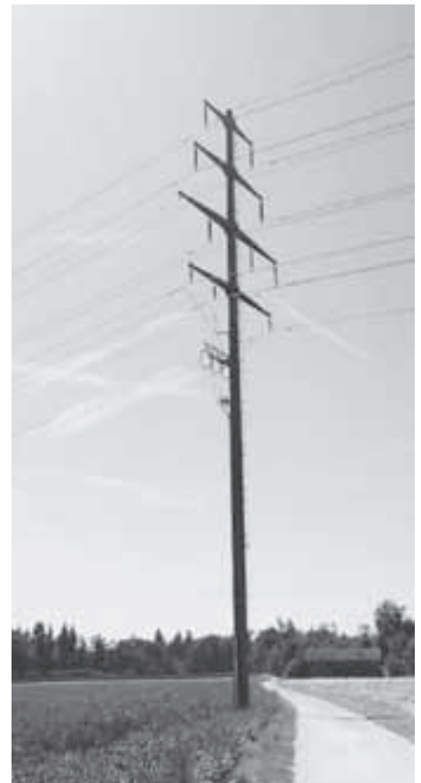
Strommast AEW Energie AG, Einspeisung TS Seefeld (EWS)
